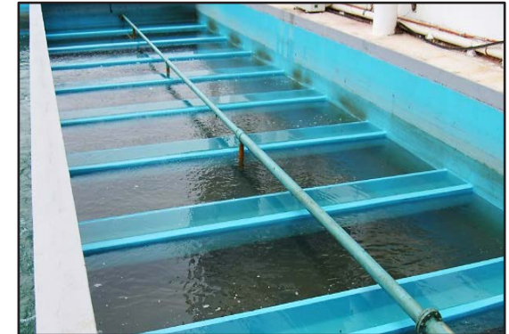
Filtro de arena en servicio.
