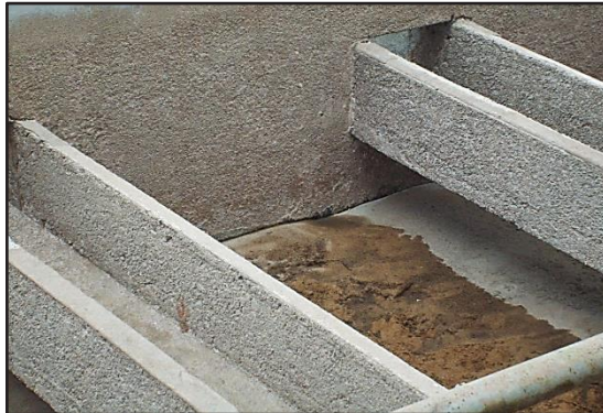
Filtro de arena drenado.
